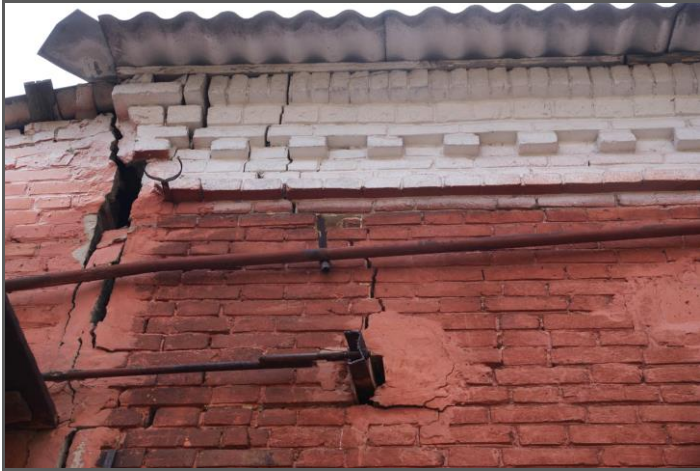
Наслідки некваліфікованого ремонту, фото автора, зима 2011 р.
